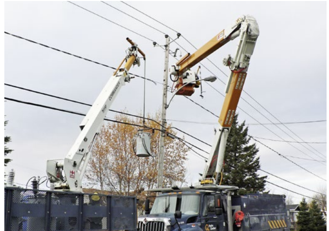
Figura 5.9-1: DT monofásico, montado en poste, Canadá
