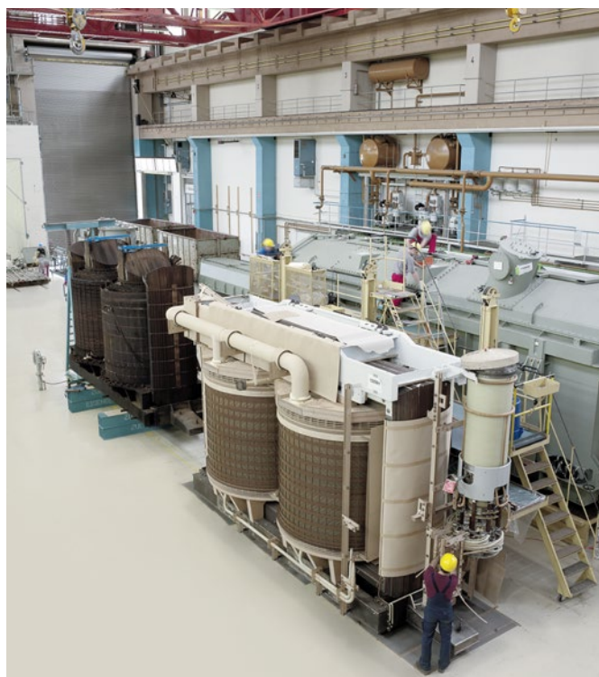
Figura 5.11-7: Taller de reparación en Nuremberg, Alemania
